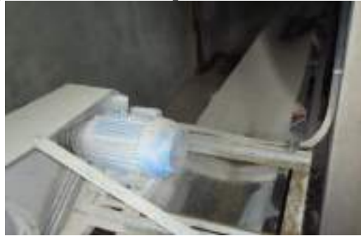
Figura 1.42: Cinta transportadora interior en Silos
